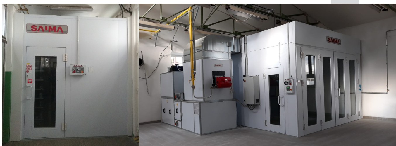
VOŠ a SŠA Zábřeh | Zábřeh LAKOVACÍ KABINA BETA ICS | MÍCHÁRNA BAREV KLEEN BOX ACCUMIX
