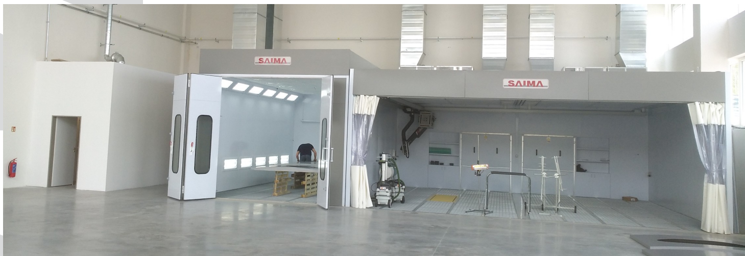
AUTOEMISTAR GROUP s.r.o. | Frýdek Místek LAKOVACÍ KABINA BETA | ODSÁVACÍ STĚNA SAIMA 9
